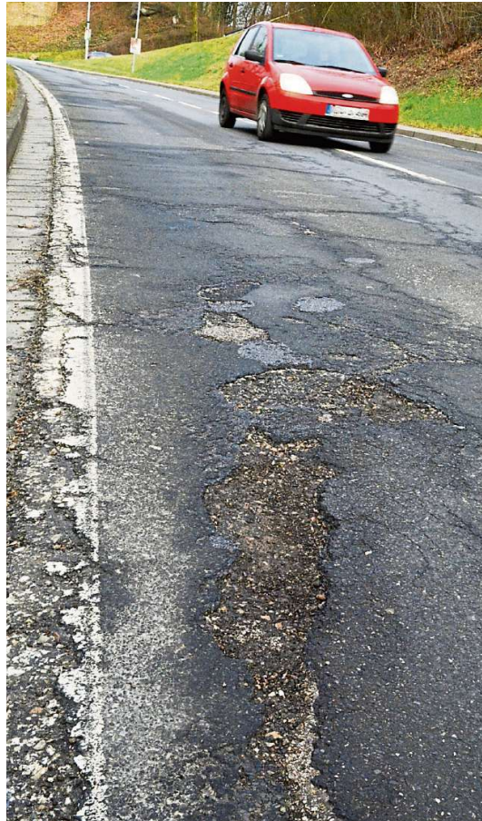
Die Deckschicht der Binger Straße zwischen Stromberger Stadtmitte und Kreisverkehr an der Autobahn gleicht einem Flickenteppich und weist viele tiefe Schlaglöcher auf. In den Sommerferien will nun der LBM die Straßendecke abfräsen und durch eine neue Deckschicht ersetzen lassen. Foto: Norbert Krupp
